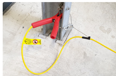
Erdung am Fundamenterder
